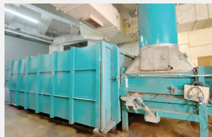
透過地下真空吸管將投入每層垃圾槽口的垃圾輸送到中央垃圾站的離心室，經壓縮後再運走
