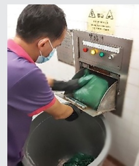
連接自動垃圾收集系統的垃圾槽口
