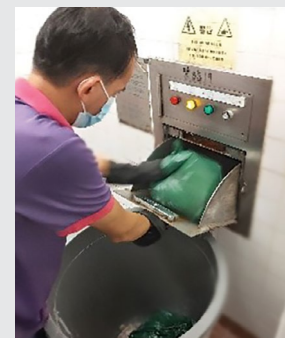
連接自動垃圾收集系統的垃圾槽口
