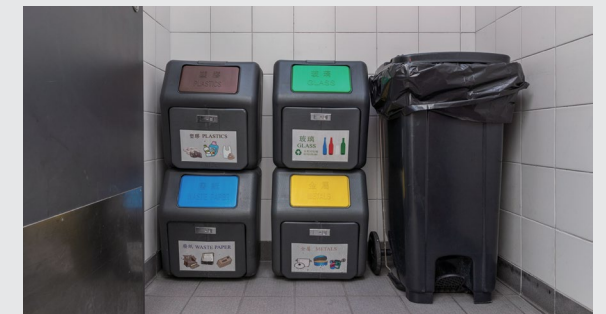
設於樓層垃圾房的分類回收設施例子
