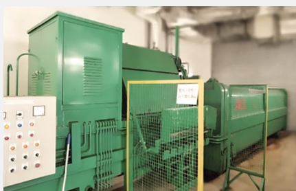
垃圾斗沒有內置壓縮系統，垃圾房需設置固定的壓縮系統
